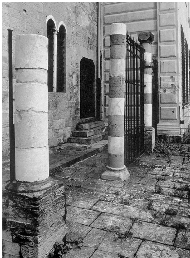
Fig. 3 – Palazzo San Giorgio. Colonne medievali ricomposte messe in luce dalla demolizione dell’ampliamento tardoquattrocentesco verso nord.
