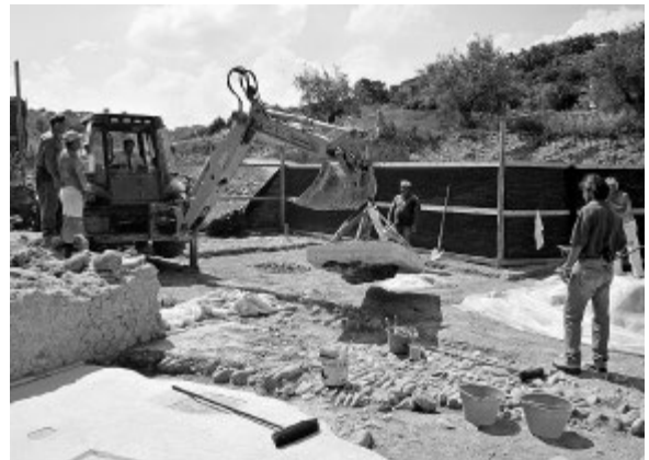
fig. 5 – Teramo, fase operativa di distacco di una porzione di muratura in crollo: il paramento a terra conserva ancora lo strato di intonaco nonostante il violento impatto a terra per distacco basale e rotazione verso l'interno.
