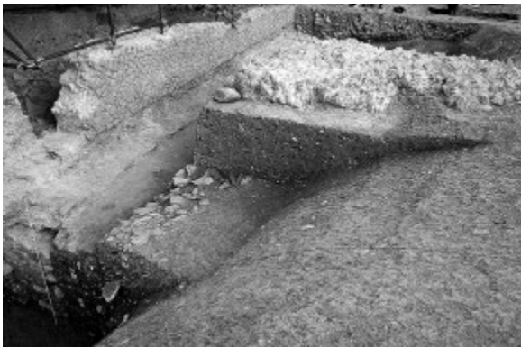
fig. 3 – Teramo, isolamento e pulitura di una porzione di muratura in opus incertum prima della cerchiatura e fissaggio in funzione del distacco; gli elementi lapidei dell'opera incerta sono stati "scarnificati" del nucleo cementizio e fermati con uno strato di malta che potrà essere facilmente rimosso in fase di ricollocamento o rimontaggio.
