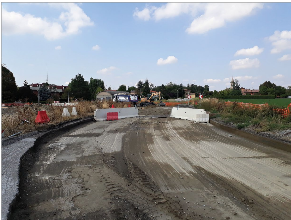
fig. 1 – Lavori in corso per la realizzazione della SP87 – Nuova Galliera (foto Città Metropolitana di Bologna).
