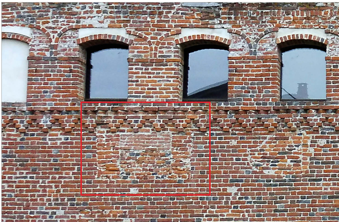
Fig. 164 – Prospetto nord: dettaglio delle merlature e, nel riquadro, intervento di scasso per un'apertura mai realizzata.
